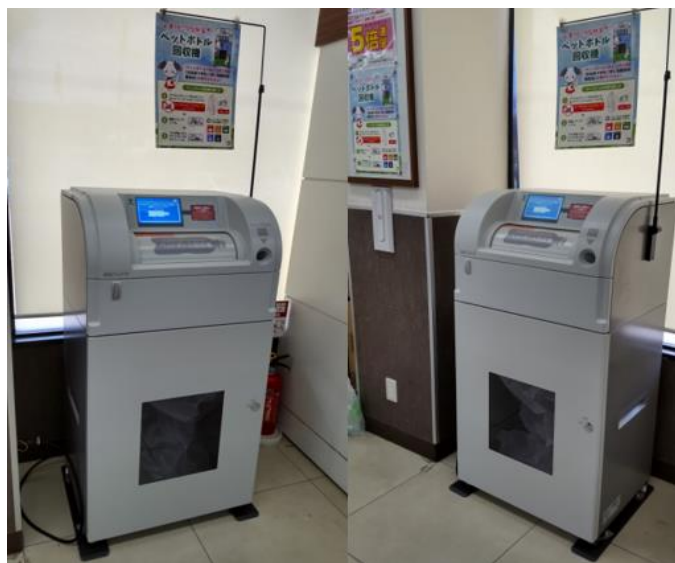
※河内長野店設置状況
